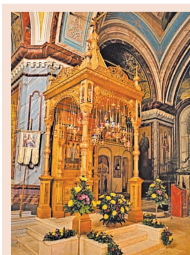
11—12 декабря. Монтаж новой резной сени для чудотворной иконы Николы Зарайского в Иоанно-Предтеченском соборе
